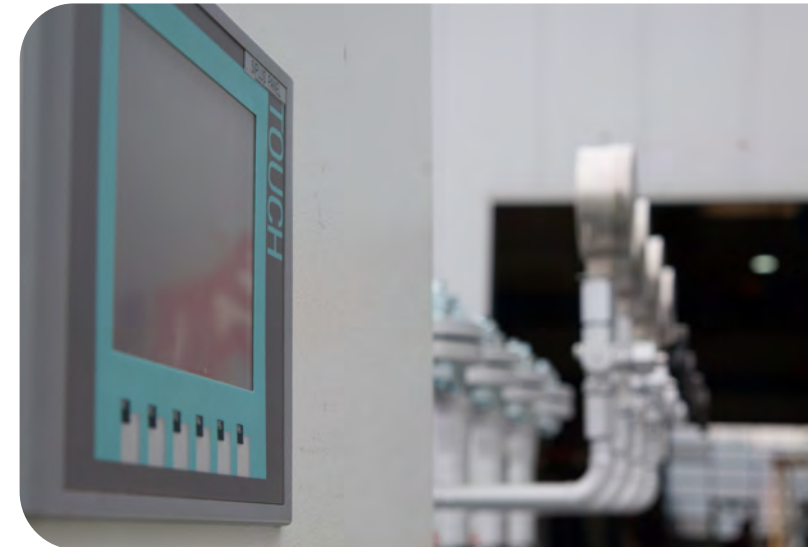
Un panneau d'utilisation local installé sur une station pétrolière
